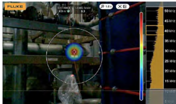
Mit dem Fluke ii910 erfasstes Dampfleck in einer Lebensmittel- und Getränkeherstellungsanlage
